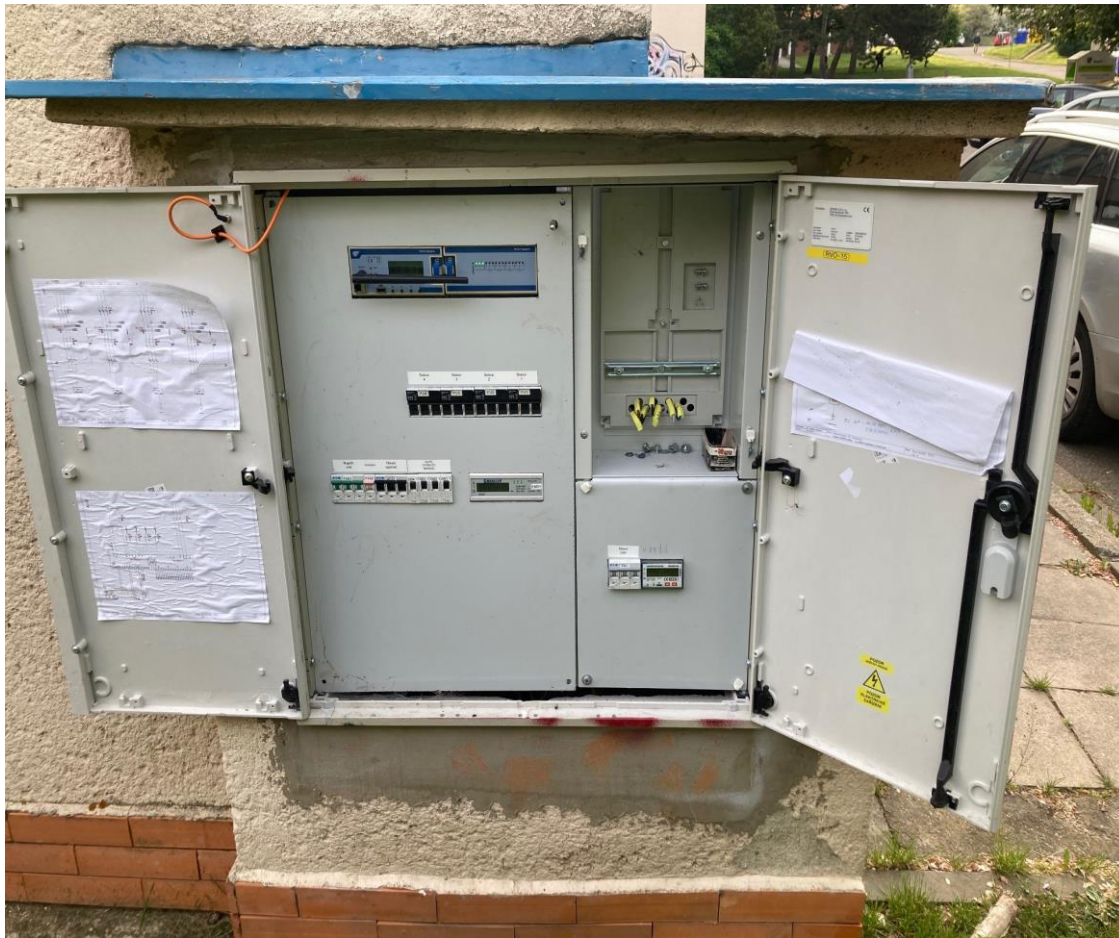
rozvaděč veřejného osvětlení
