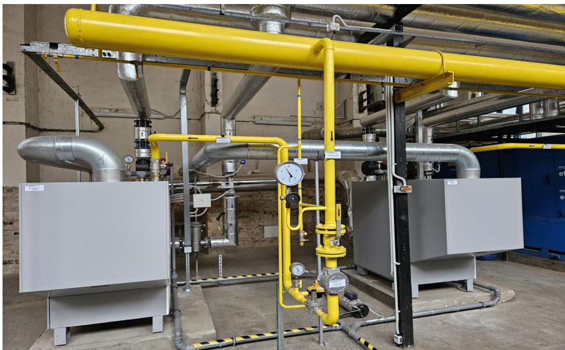
nové kotle v kotelně K 404 Na Vyhlídce
